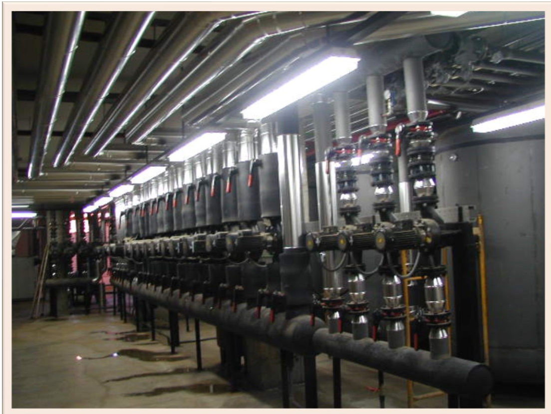
Asistencia Técnica para el mantenimiento de sala de máquinas.
