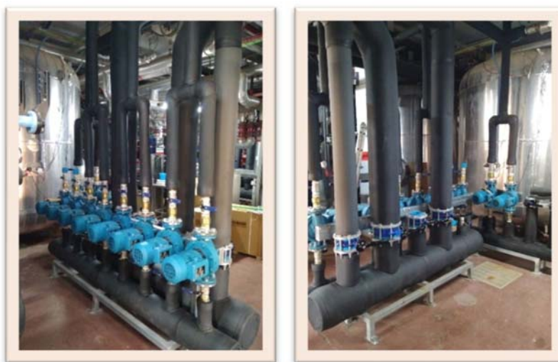
Sala de máquinas – Colector retorno de agua caliente sanitaria
